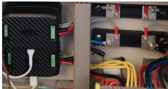
ภาพที่ 8 แสดงมิเตอร์วัดค่าไฟฟ้ากระแสตรง วัดค่าพลังงานไฟฟ้าที่ผลิตได้ของแผงเซลล์แสงอาทิตย์ และวัดค่าพลังงานไฟฟ้าที่ผลิตได้ของเครื่องกำเนิดไฟฟ้า
