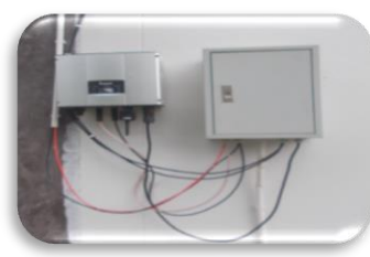
ภาพที่ 4 อินเวอร์เตอร์และชุดควบคุม
